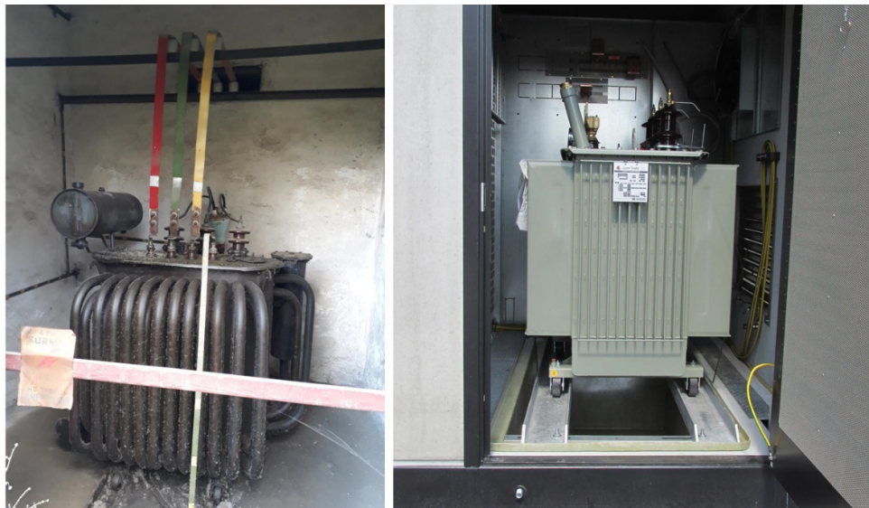
Lisa 35. Jaotusalajaamades jõutrafode asendamine. Uued trafod on kahe ülempingega 6(10)/0,4 kV.
